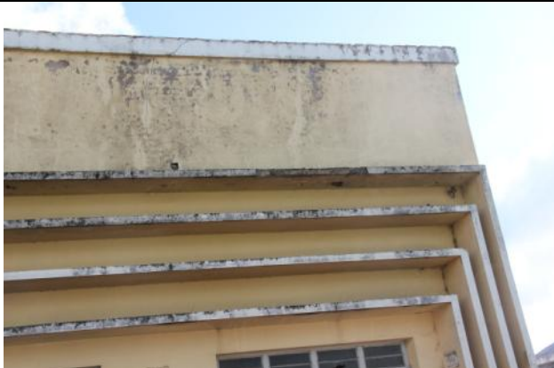
Detalhe cimalha Rua Hercílio Luz
